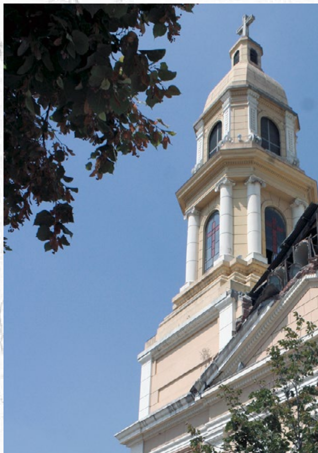
El templo ícono de la diócesis resultó con severos daños.
