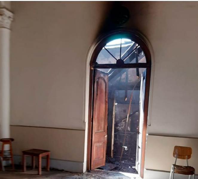
Esta puerta que da al templo impidió que el fuego entrara en él.
